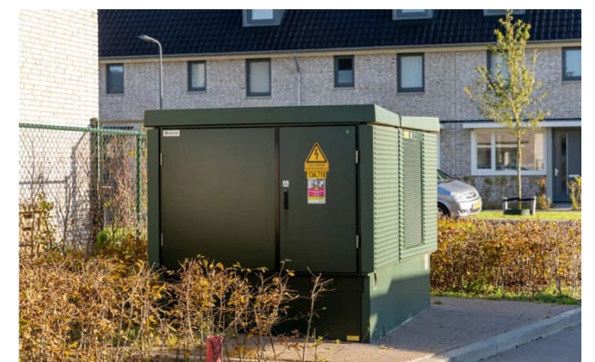
Transformatorhuisje in woonwijk
